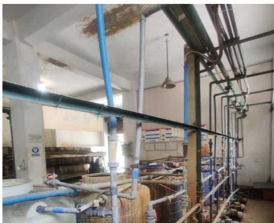
图 3.3.2-1 废水处理药剂运输管道
