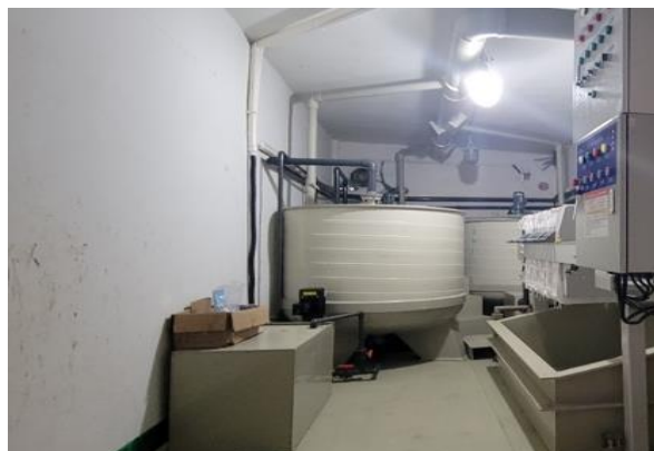
图 3.3.1-4 退锡废液循环再生回用系统储罐
