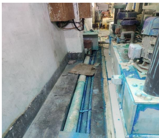
图 3.3.2-3 蚀刻线药剂运输管道
