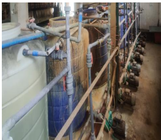
图 3.3.2-9 废水处理药剂传输泵
