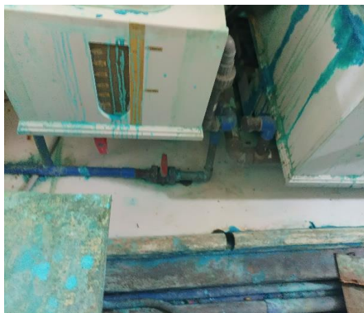
图 3.3.2-4 蚀刻线废水管道
