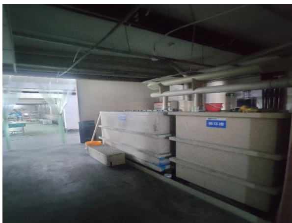
图 3.3.1-10 蚀刻线药水循环槽
