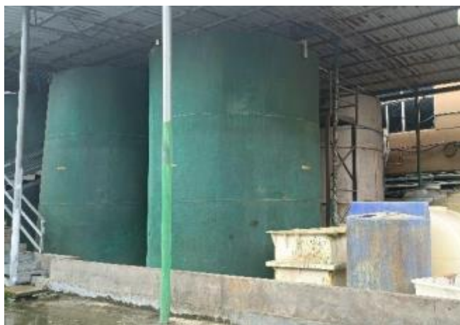
图 3.3.1-1 废水处理储罐
