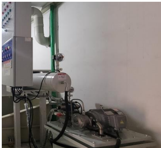
图 3.3.2-8 退锡废液循环再生回用系统传输泵
