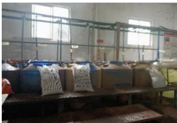
图 3.3.1-5 废水处理药剂调配储罐
