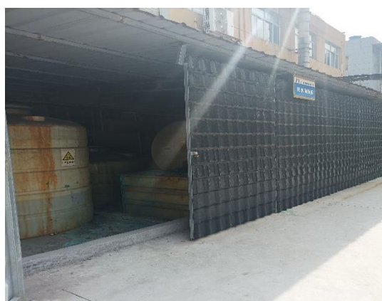
图 3.3.1-2 药水周转区储罐
