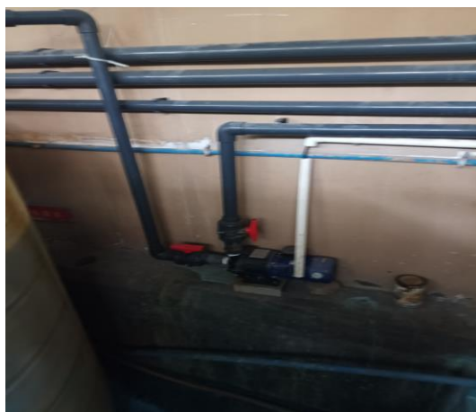
图 3.3.2-7 蚀刻线废水传输泵
