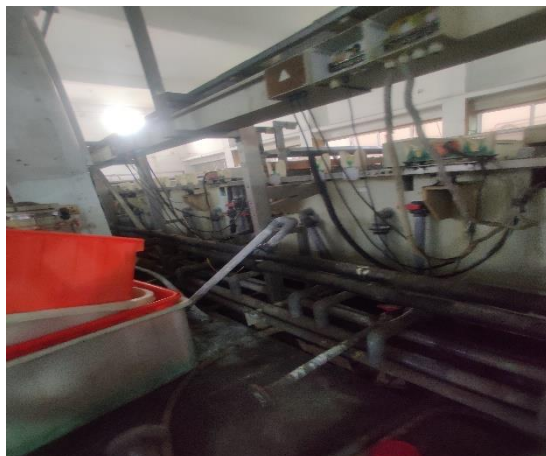
图 3.3.2-2 电镀线废水管道
